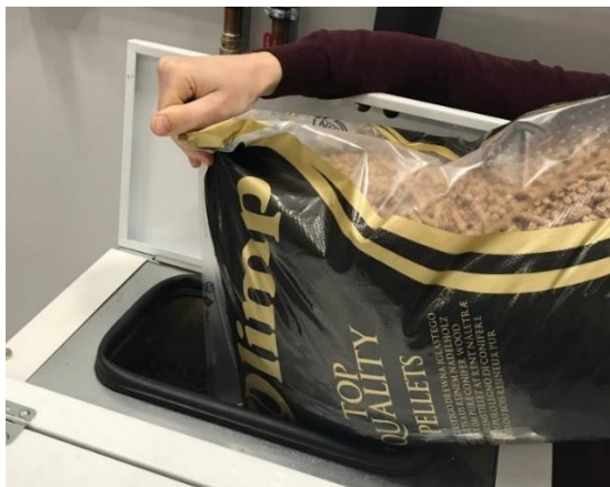
NAPEŁNIANIE ZBIORNIKA PALIWA
